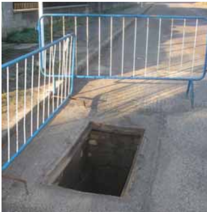
Hluboké díry po ukradených kanalizačních vpustích jsou velmi nebezpečné pro chodce, automobily i cyklisty.
