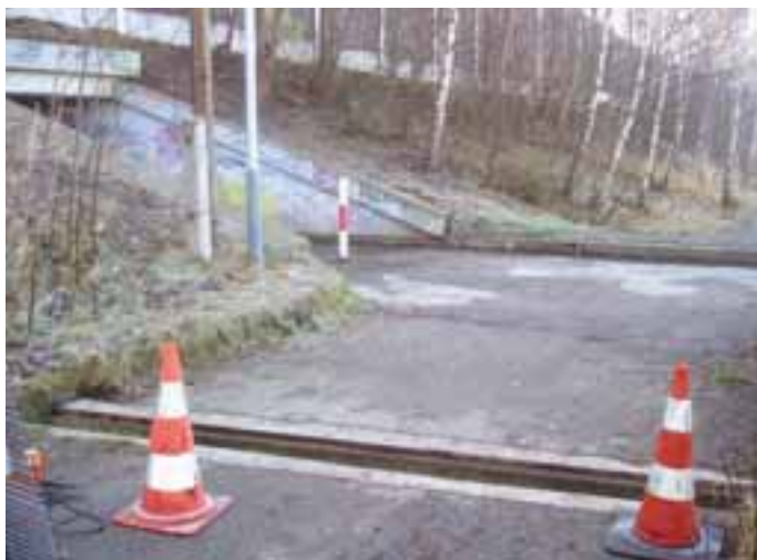
U podjezdu pod dálnicí v ulici Dobrošovské vznikla následkem krádeže nebezpečná jáma přes celou šířku silnice.
