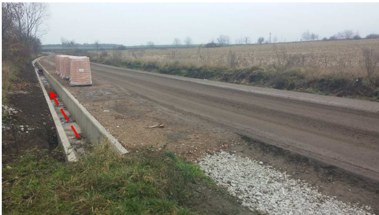
Obr. 7 – Odvodňovací žlab ulice Tlustého (pohled z křižovatky Tlustého/ K odpočinku směrem na ul. Bořetická)
