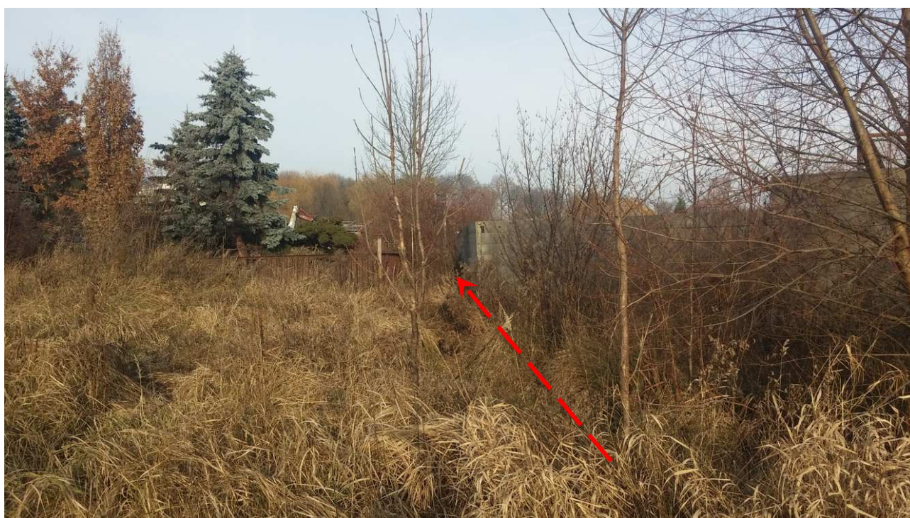
Obr. 16 – Zanešené koryto vodoteče mezi oploceními
