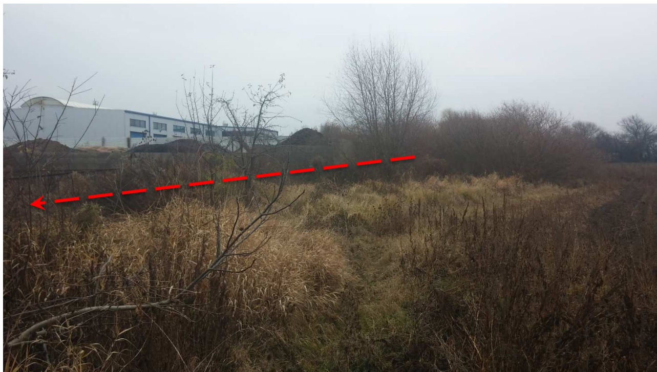
Obr. 15 – Zanešené koryto vodoteče podél oplocení
