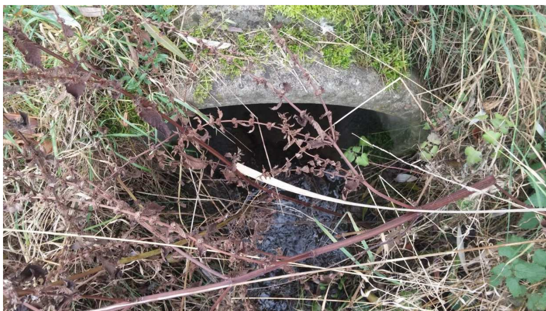
Obr. 22 – Vyústění zatrubněné vodoteče do jižního břehu rybníka (zanešené, zatopeno)
