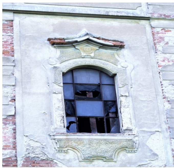
Vodárenská věž potřebuje opravu
