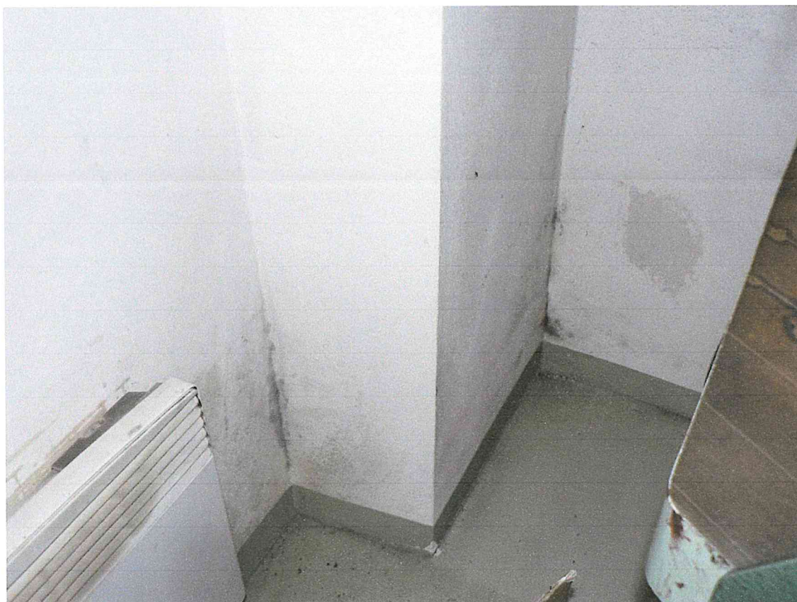
Plíseň na stěnách 2. místnosti provozovny Tiskárny PRINTEA Náchodská 868 / 28.
