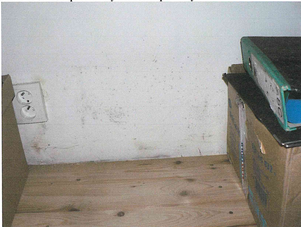
Plíseň na stěnách provozovny Zdravotní pomůcky Náchodská 868 / 28.
