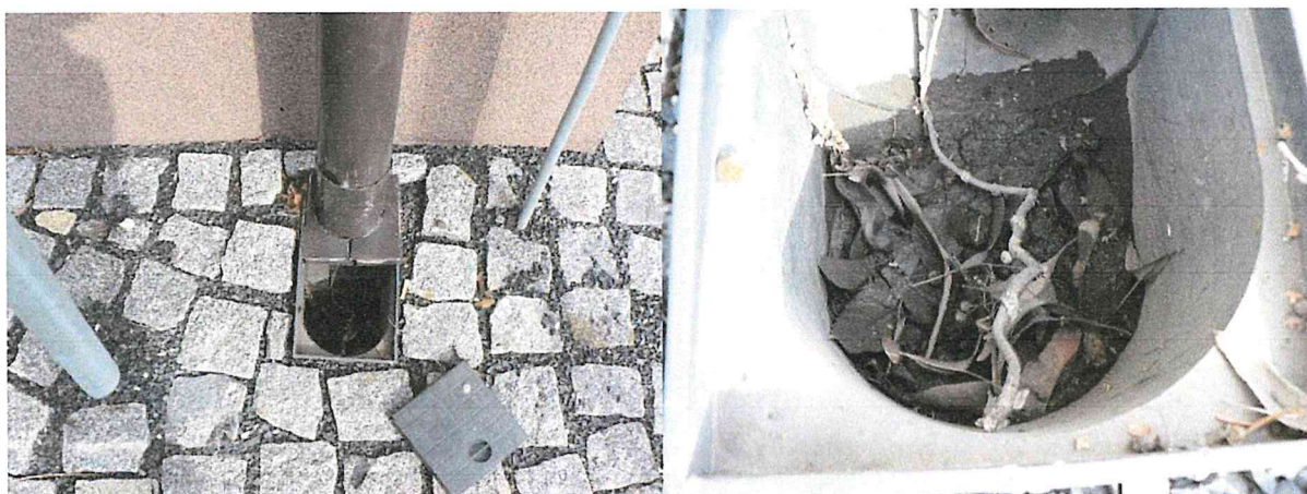
Ucpaný lapač nečistot v okapovém svodu na rohu domu v Náchodské č. 26.
