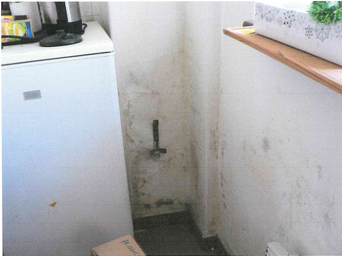
Plíseň na stěnách 3. místnosti provozovny Tiskárny PRINTEA Náchodská 868 / 28.
