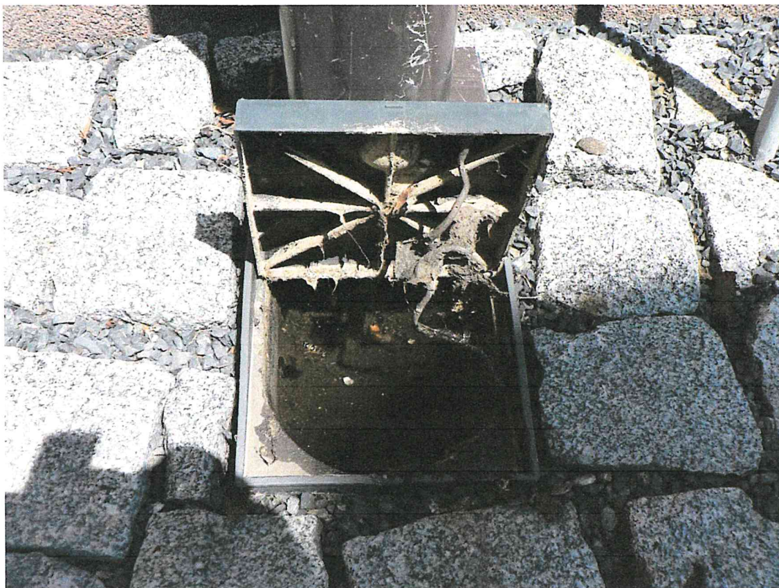
Ucpáný lapač nečistot okapového svodu na rohu domu v Náchodské č. 26.
