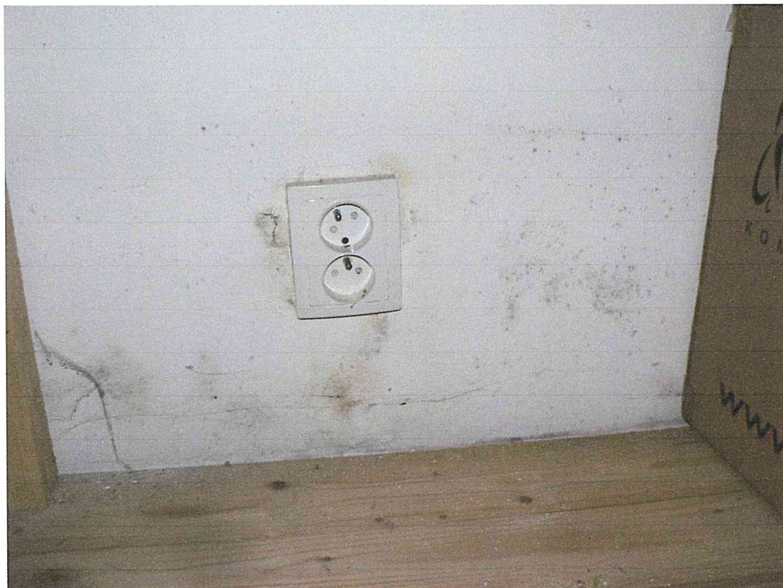
Zásuvka ve skladu provozovny Zdravotní pomůcky s okolní plísní na stěně.
