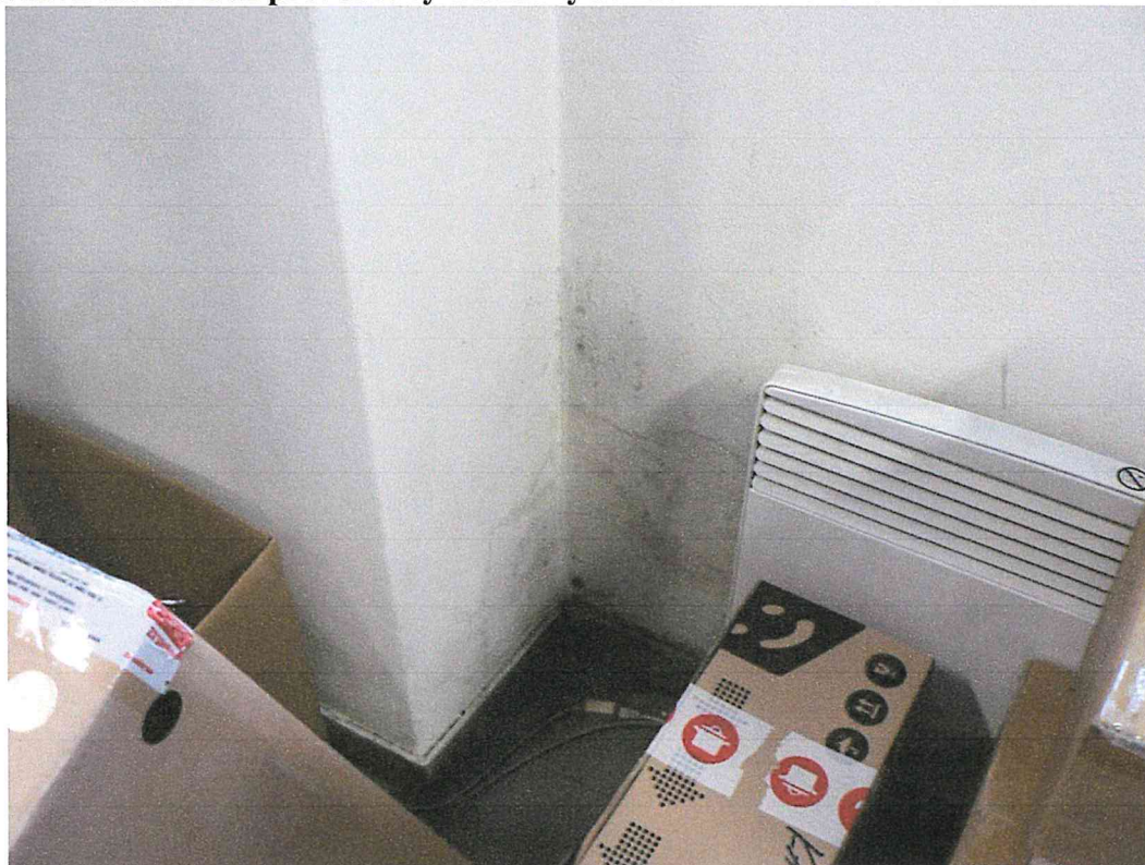
Plíseň na stěnách provozovny Tiskárny PRINTEA Náchodská 868 / 28.
