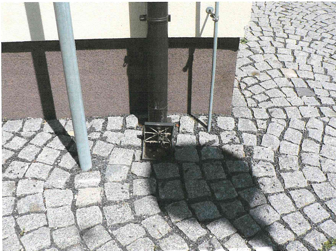
Ucpaný lapač nečistot okapového svodu na rohu domu v Náchodské č. 26.
